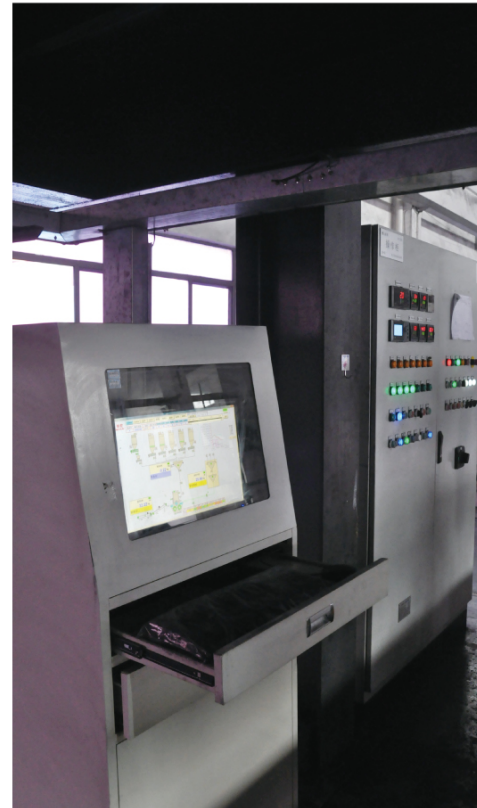
计算机控制系统 Computer control system
