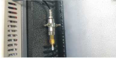
压力变送器 Pressure transmitter
