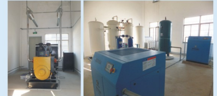
500KW发电机 500KW generator
