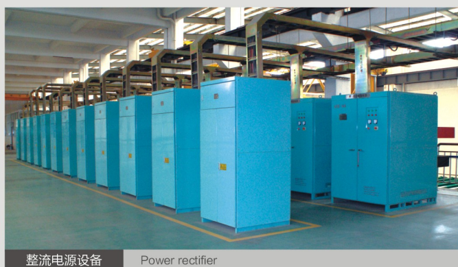
整流电源设备 Power rectifier
